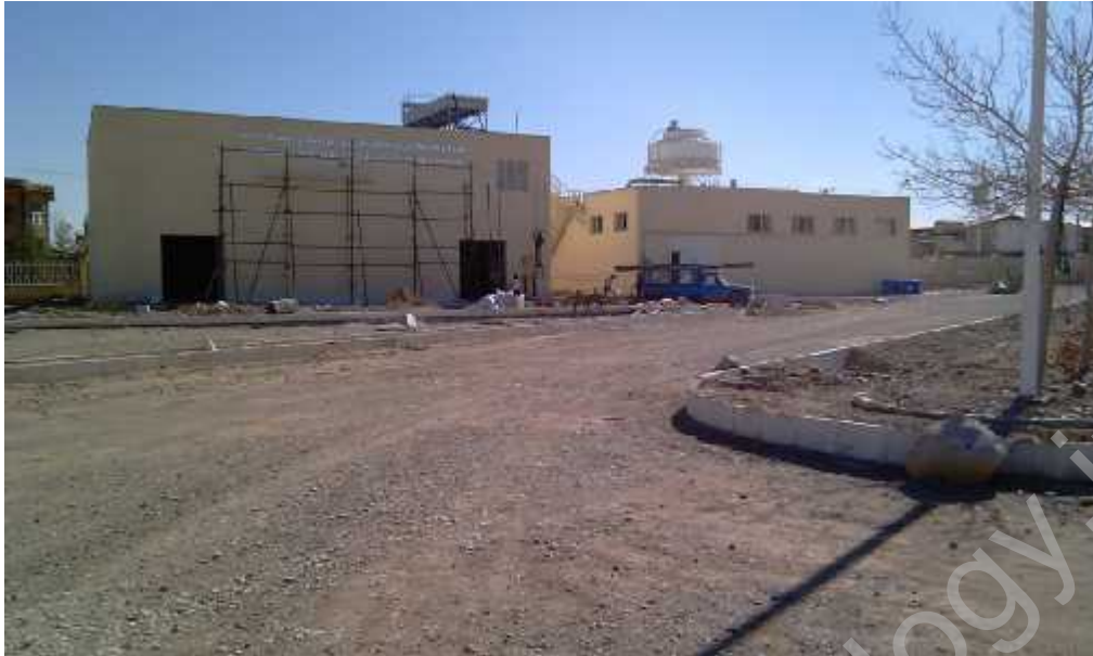
شکل ۲- نمای بیرونی ساختمانهای محل نصب چیلر جذبی و ملحقات آن (ساختمان سمت راست) و محل نصب سیستم CHP (ساختمان سمت چپ)
