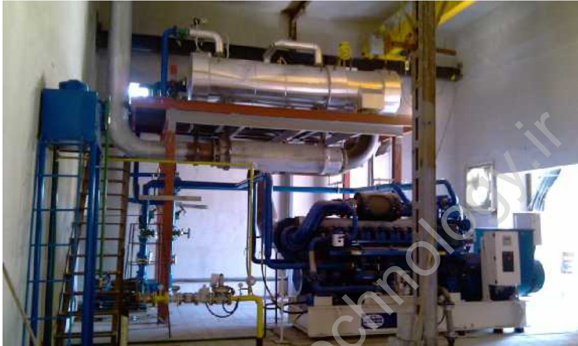
شکل ۴- نمایی از کل تجهیزات نصب شده در سالن CHP شامل موتور-ژنراتور، مبدل حرارتی، پمپها، ورودی گاز و غیره
